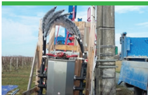
Exemple d'un Auguste ou IA3T installé sur un réseau aérien haute tension et d'une AC3T (armoire de coupure télécommandée) installée sur un réseau souterrain haute tension
